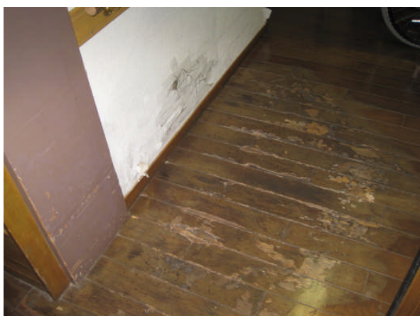
（漏水により腐食した床）
