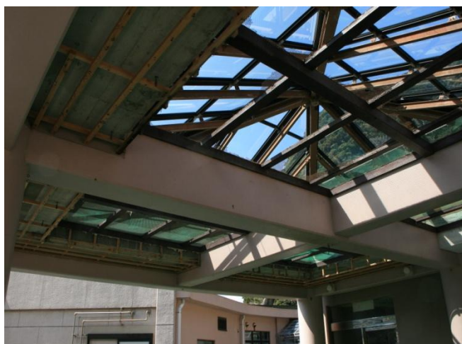
（崩落した三階エントランスの天井部分の写真）
